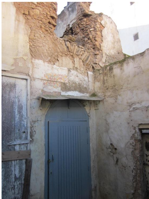
Constructions menaçant ruine
